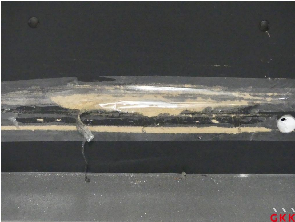
Bild 21 Laderaum, Abdeckung, beschädigt, ersetzen
