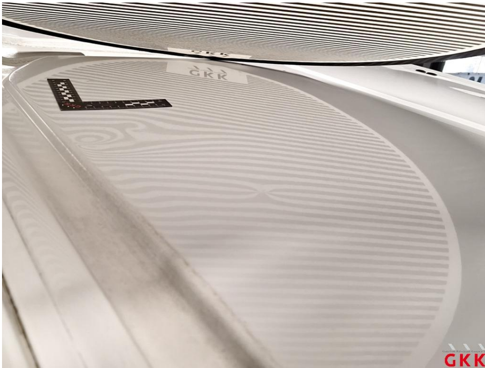
Bild 22 Dach, beschädigt, kalt drücken
