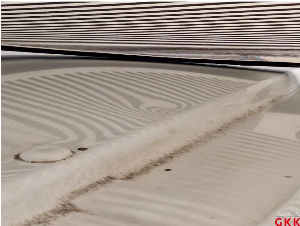
Bild 24 Dach, beschädigt, kalt drücken
