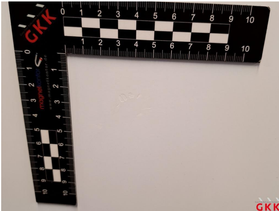
Bild 15 Seitenwand links, Lackierung abgeplatzt, auslegen, schleifen, polieren
