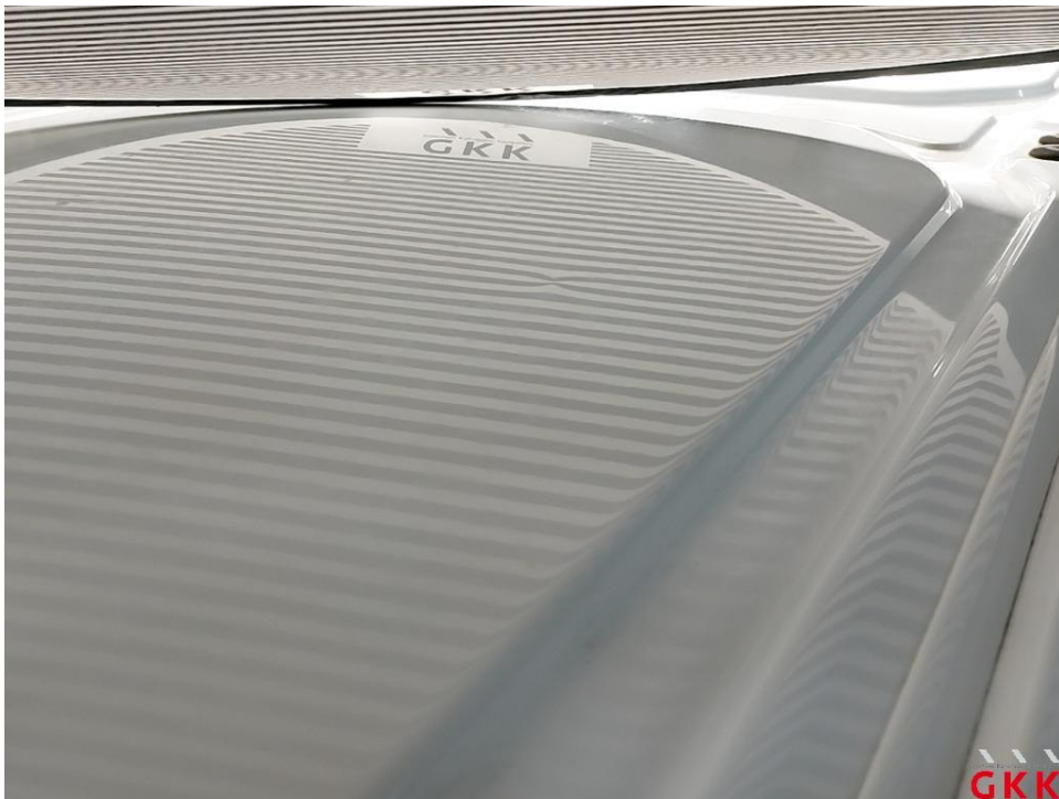
Bild 14 Dach, beschädigt, kalt drücken
