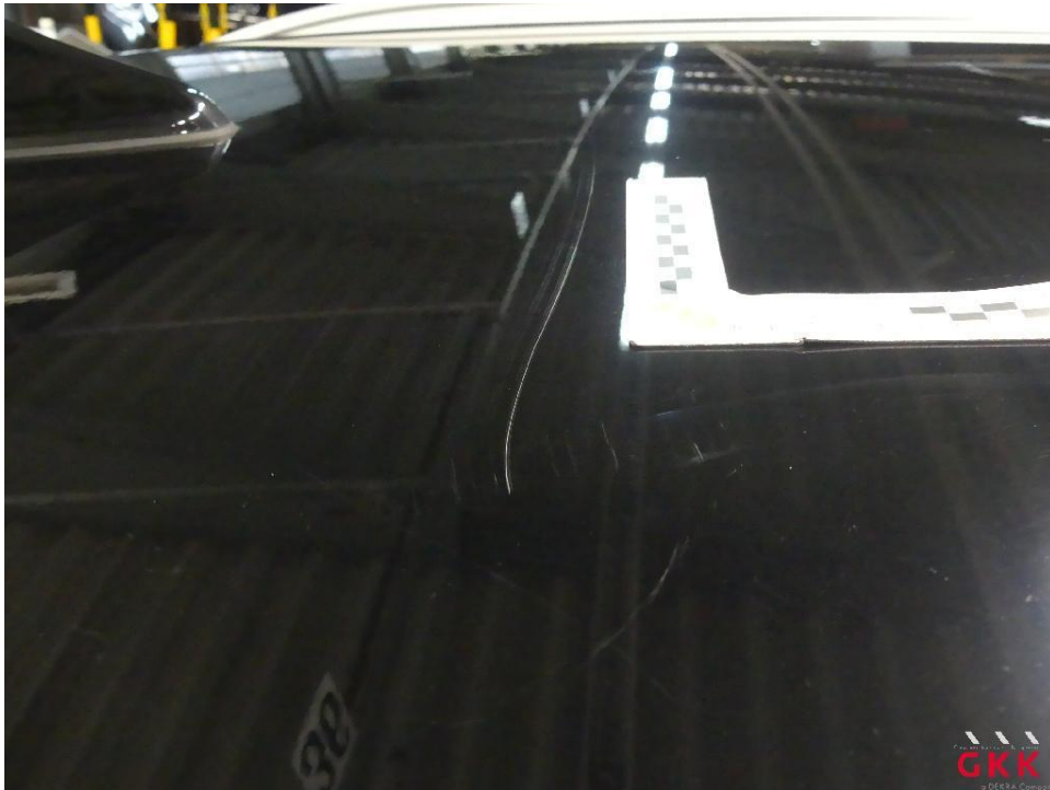
Bild 31 Dach, verkratzt, lackieren
