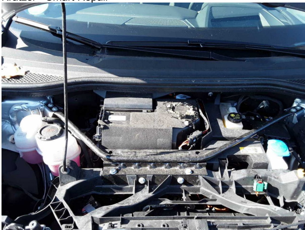
Beschädigung #4: Fahrerhaus: Dämmmatte - gebrochen / gerissen - erneuern
