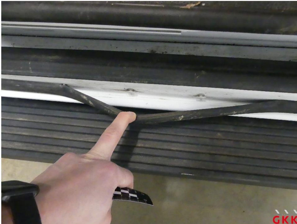
Bild 15 Schiebetür rechts, Dichtung -Einstieg-, lose, ersetzen
