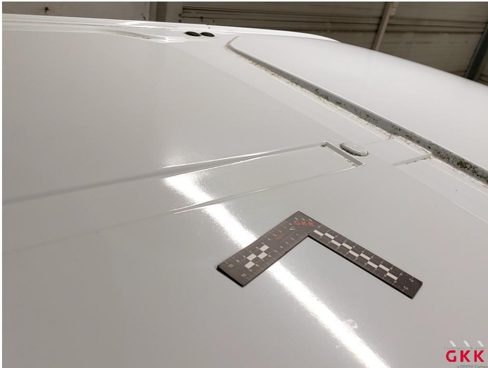
Bild 17 Dach, Reparaturmangel, instand setzen - lackieren
