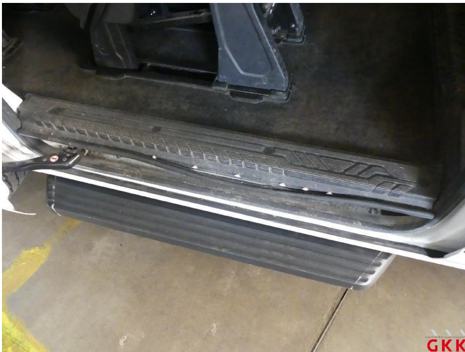
Bild 14 Schiebetür rechts, Dichtung -Einstieg-, lose, ersetzen
