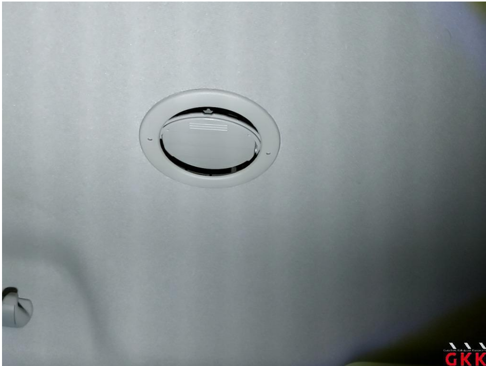
Bild 19 Himmel Luftdüse hinten, beschädigt, ersetzen
