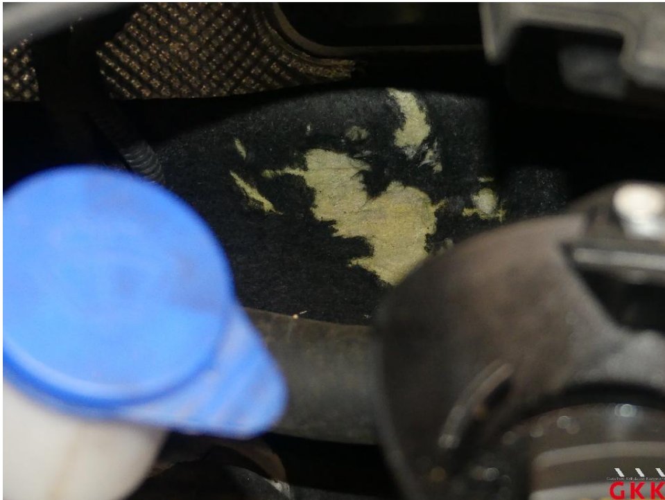
Bild 27 Motorraum, Dämmmatte, beschädigt, ersetzen
