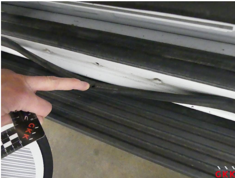
Bild 16 Schiebetür rechts, Dichtung -Einstieg-, lose, ersetzen
