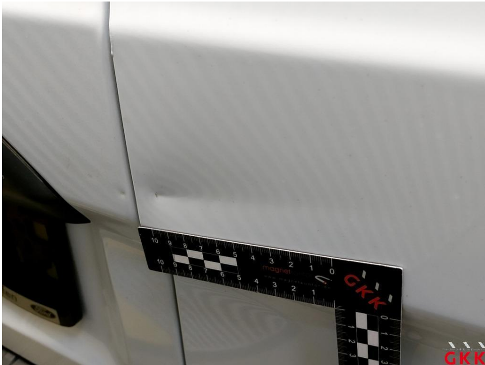
Bild 27 Hecktür rechts, beschädigt, instand setzen
