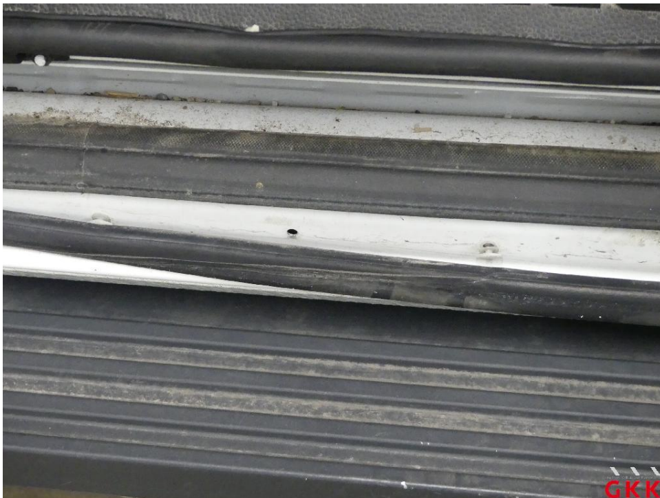
Bild 24 Schiebetür rechts, Dichtung -Einstieg-, lose, ersetzen
