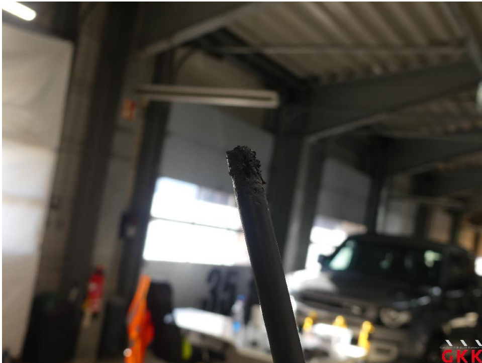
Bild 19 Antenne, Stab, beschädigt, ersetzen
