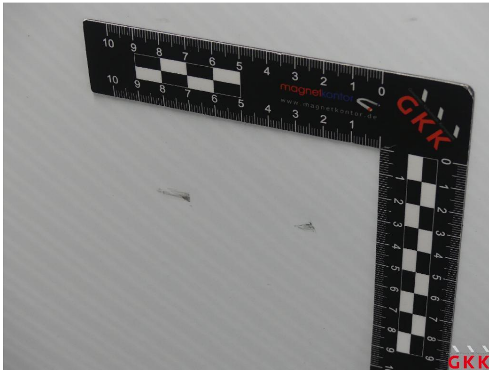
Bild 20 Schiebetür rechts, beschädigt, instand setzen - lackieren
