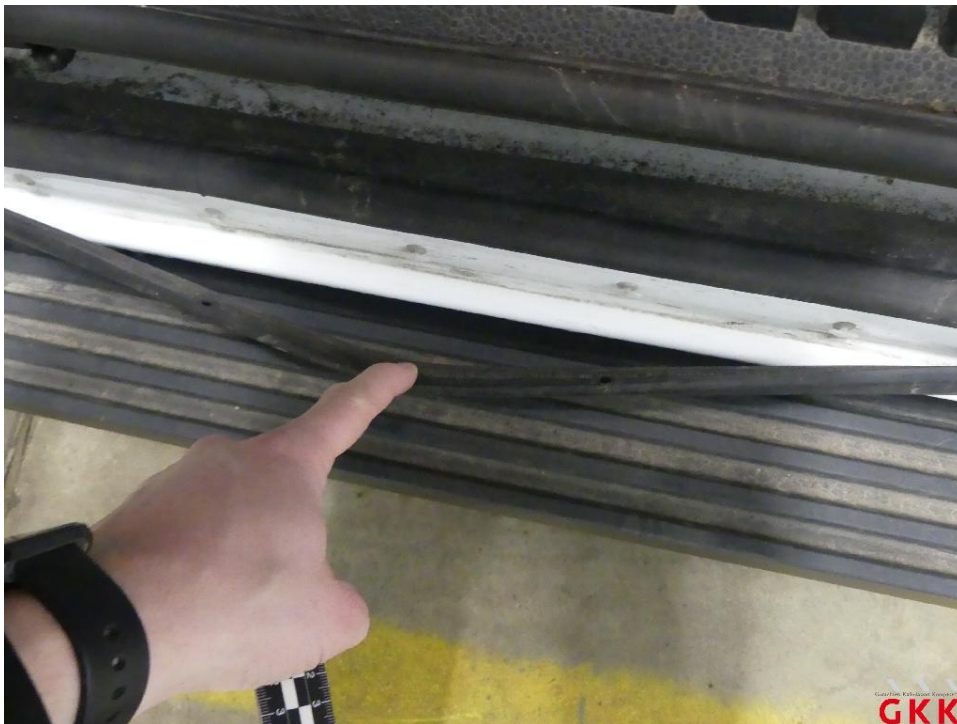
Bild 22 Schiebetür rechts, Dichtung -Einstieg-, lose, ersetzen
