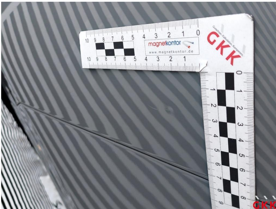
Bild 30. Seitenwand links, bis 3 Dellen / Bauteil, Smartrepair
