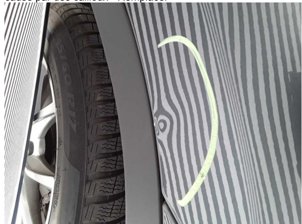
Domage #4: Panneau latéral arrière gauche: Paroi latérale - Bosse, dommage peinture - Réparer et repeindre
