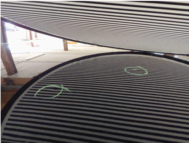
Domage #4: Toit: Toit - bosse(s) - Bon travail de réparation
