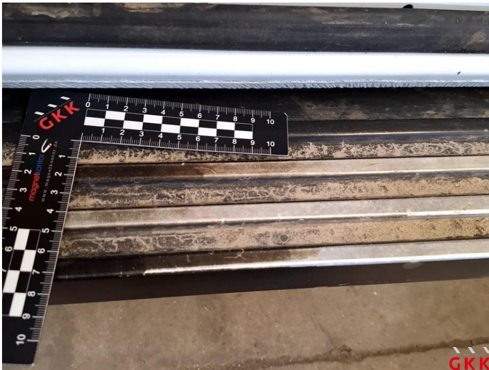
Bild 28 Trittstufe rechts, Lackierung abgeplatzt, lackieren
