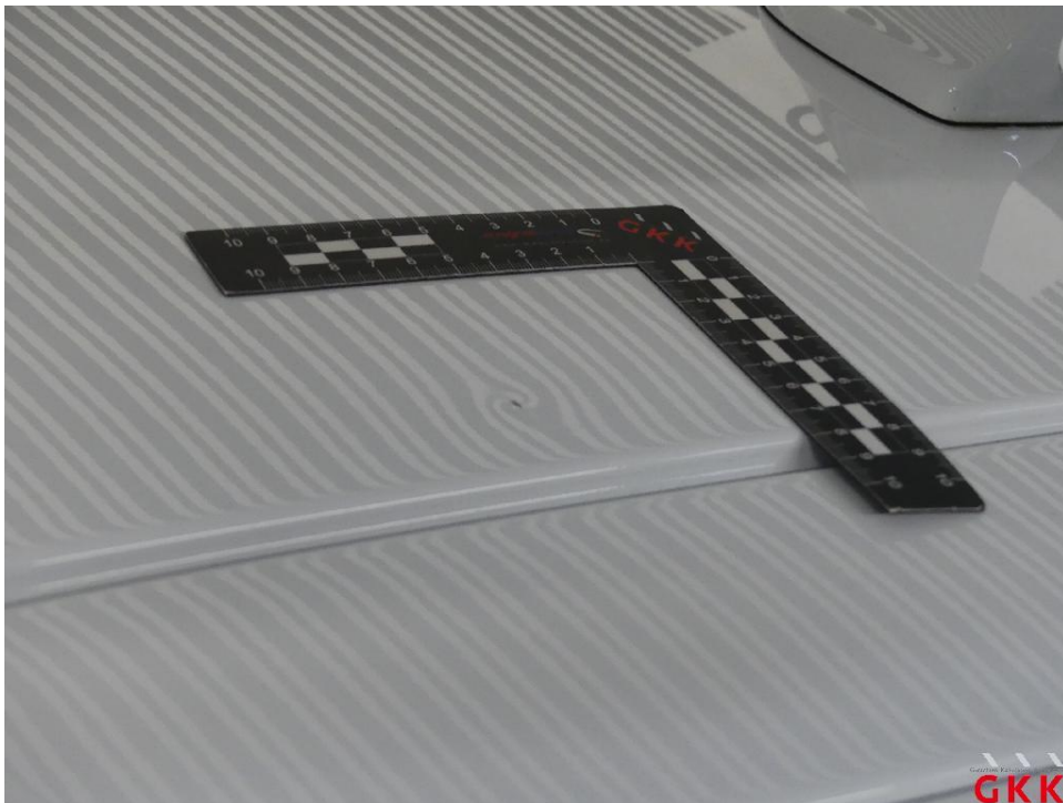
Bild 24 Dach, beschädigt, instand setzen - lackieren
