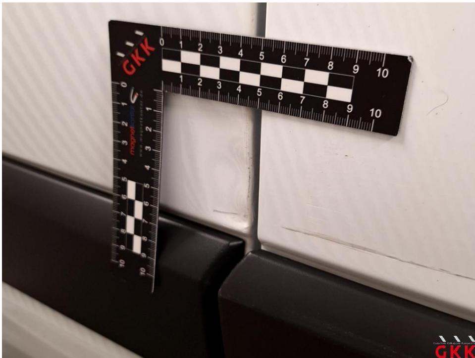
Bild 36 Schiebetür rechts, beschädigt, instand setzen - lackieren
