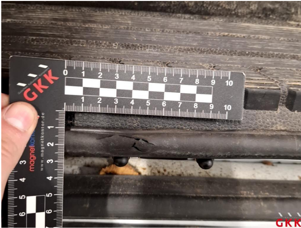
Bild 39 Schiebetür rechts, Dichtung -Einstieg-, beschädigt, ersetzen
