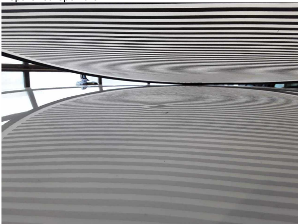
Domage #11: Toit: Toit - bosse(s) - Réparer et repeindre
