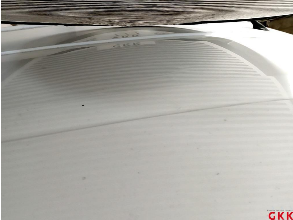
Bild 15 Dach, beschädigt, instand setzen - lackieren
