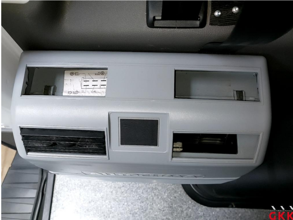
Bild 17 Lüftung/Clima Laderaum / Luftdüsen, fehlt, ersetzen
