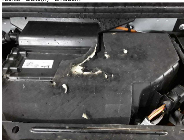
Beschädigung #4: Motor: Motorabdeckung oben / Blende - Marderschaden - erneuern
