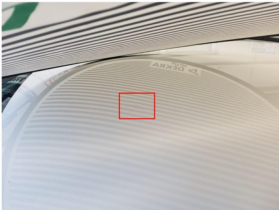
Bild 24 : Dach, mehrfach eingedellt, drücken
