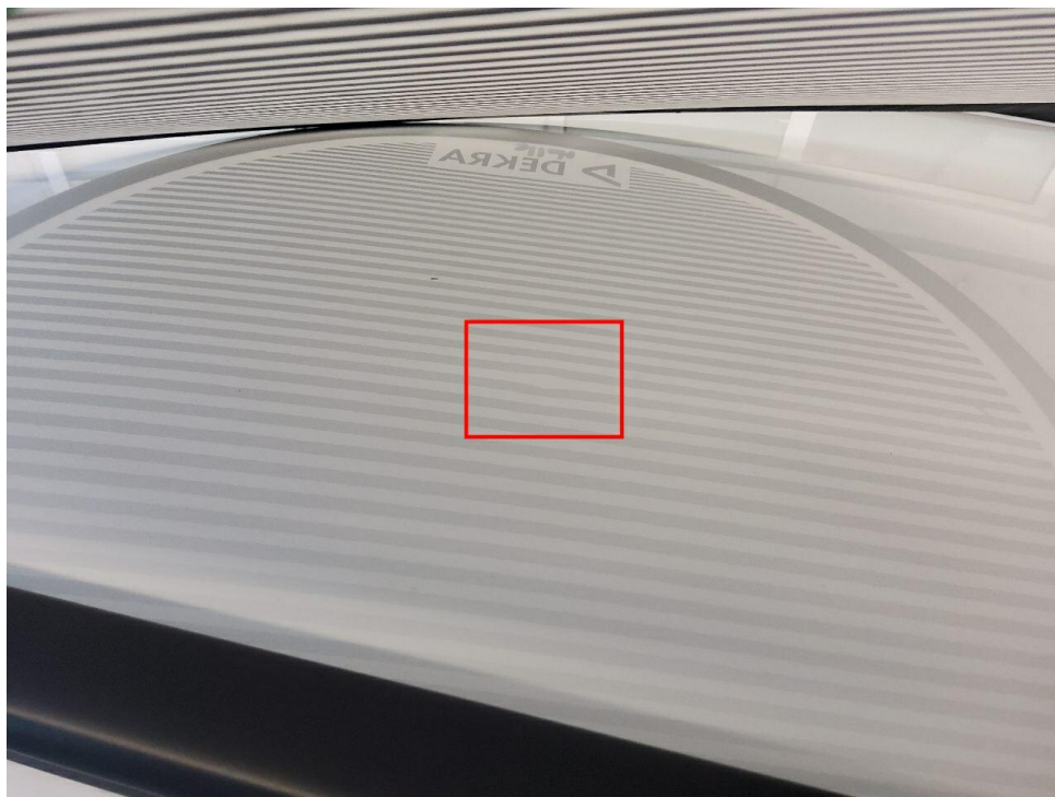
Bild 25 : Dach, mehrfach eingedellt, drücken
