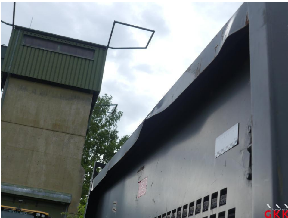
Bild 48 Trenngitter, beschädigt, instand setzen
